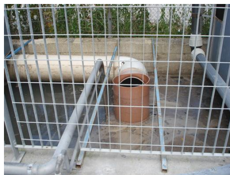
Bacino di sedimentazione secondaria
