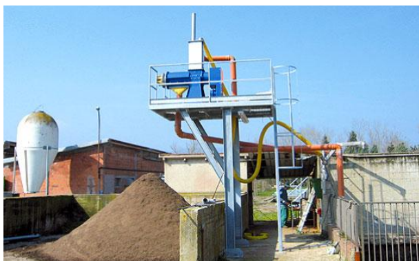
Stazione di filtrazione
