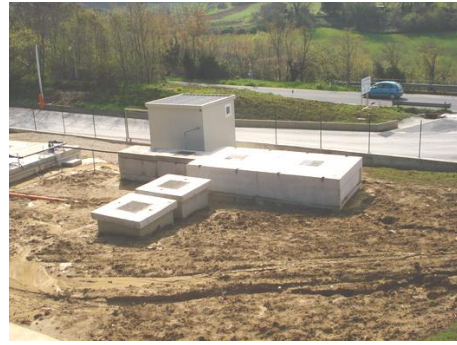
Depuratore chimico-fisico in operazione
