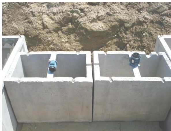
Pozzetti di flocculazione
