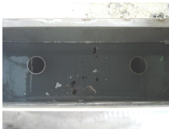
Comparto di regolazione del livello e di scarico dell'acqua depurata
