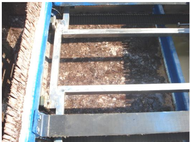
Risalita del fango nella vasca di flottazione
