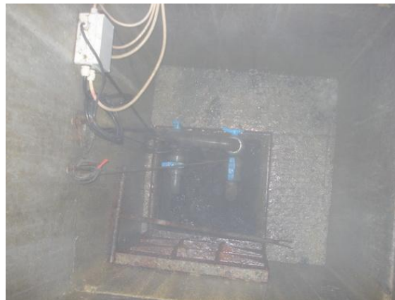
Bacino di raccolta e rilancio delle acque di scarico
