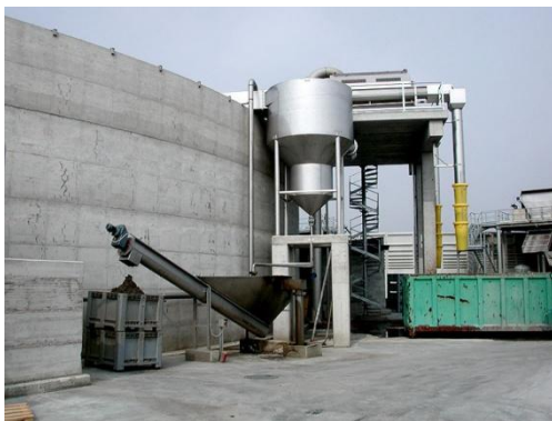
Dissabbiatore a vortice in carpenteria metallica (Fonte Veolia)
