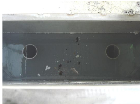
Comparto di regolazione del livello e di scarico dell'acqua depurata
