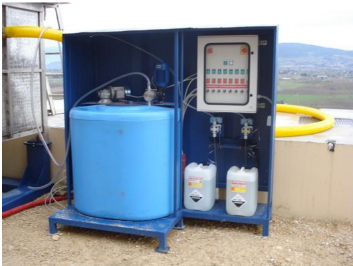
Stazione di dosaggio degli additivi chimici
