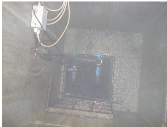
Bacino di raccolta e rilancio delle acque di scarico
