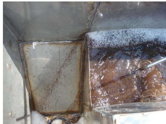
Comparto di deflusso della miscela flocculata
