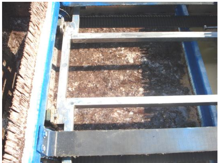
Risalita del fango nella vasca di flottazione
