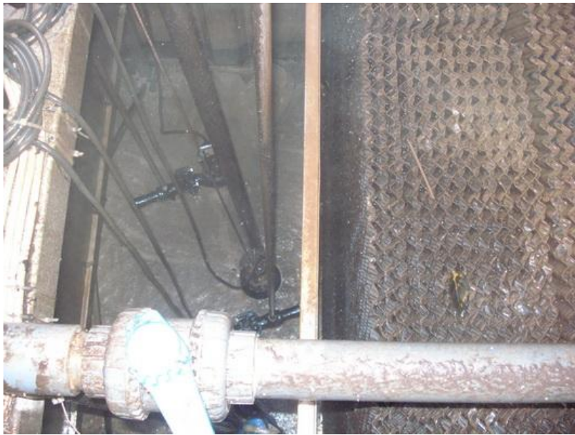
Bacino di bilanciamento idraulico e filtrazione biologica
