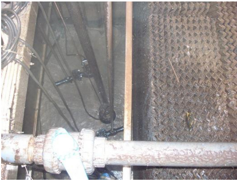
Bacino di bilanciamento idraulico e filtrazione biologica
