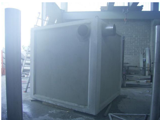
Vasca attrezzata con filtro
